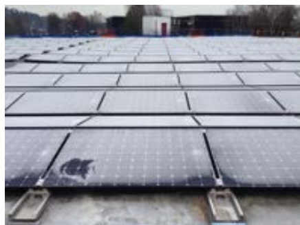
Takmonterte solceller, Powerhouse Kjørbo
